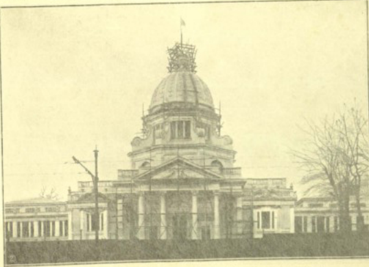
Il Palazzo della Città di Torino: stato dei lavori nel dicembre (Fot. Jacovazzi).
